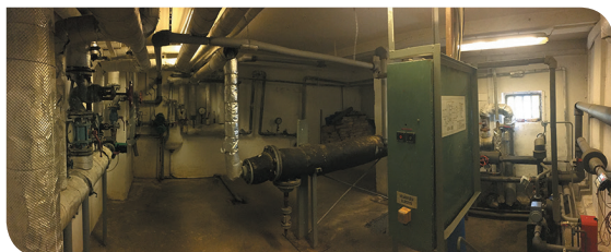
Viscosa tér 1. hőközpont felújítás előtt
