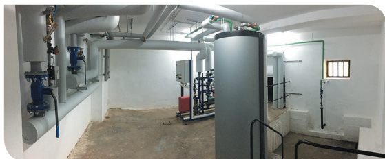
Viscosa tér 1. hőközpont felújítás után
