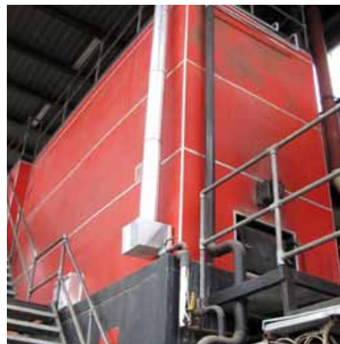
Az 5MW-os biomassza kazán
