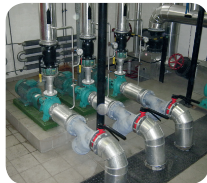
a főköri szivattyúk gépterme
